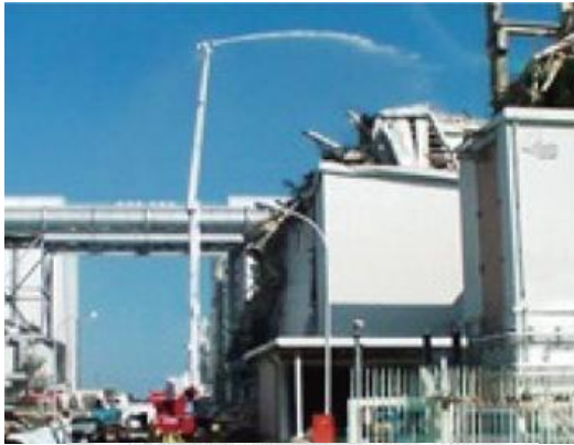
緊急消防援助隊による3号機への放水 (平成23年3月19日撮影)
